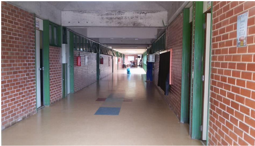
Figura 4. Corredor de acesso às salas da creche e refeitório e prédio II
